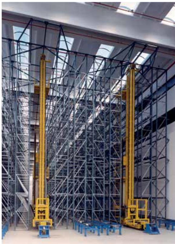
Fig. 1 - Magazzino portapallet con trasloelevatori.
