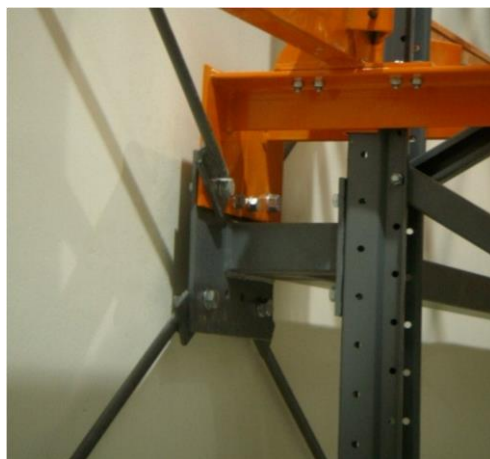
Figura 4 – Scaffale in contatto con elemento strutturale dell'edificio
