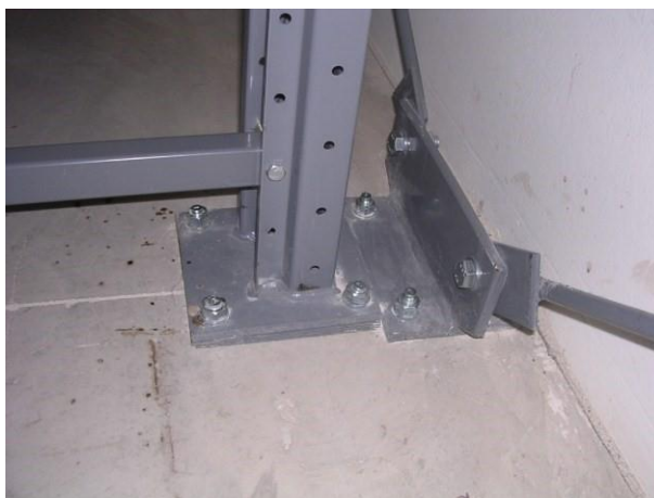
Figura 2 – installazione di attacco di base di un piastra di base per controvento in posizione eccessivamente ravvicinata al bordo della pavimentazione
