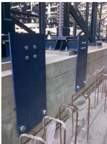
Figura 7 – Installazione di piastre per ancoraggio al fianco della platea di fondazione delle basi di uno scaffale eccessivamente vicine al bordo
