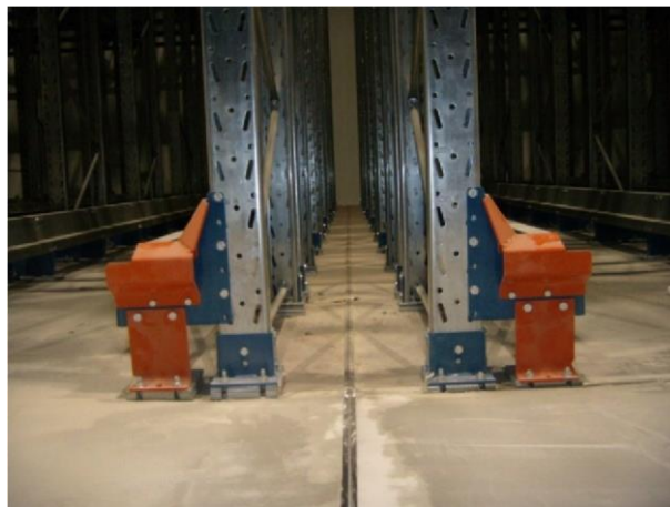
Figura 14 – Raddoppio di struttura di uno scaffale in corrispondenza di giunto del pavimento
