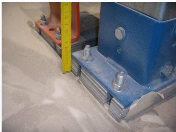
Figura 1 – Spessoramento eccessivo sotto una correggere l'eccessiva non planarità della pavimentazione
